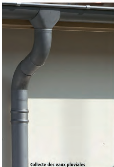
Collecte des eaux pluviales
